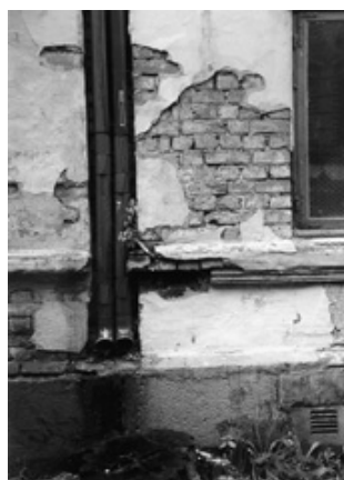
Pilestredet 30 a, b og c Eksempel på dårlig vedlikehold gjennom mange år.
