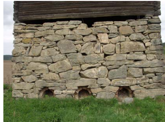
Ovnen fra siden. Åpningene til brennkanalene nederst.
